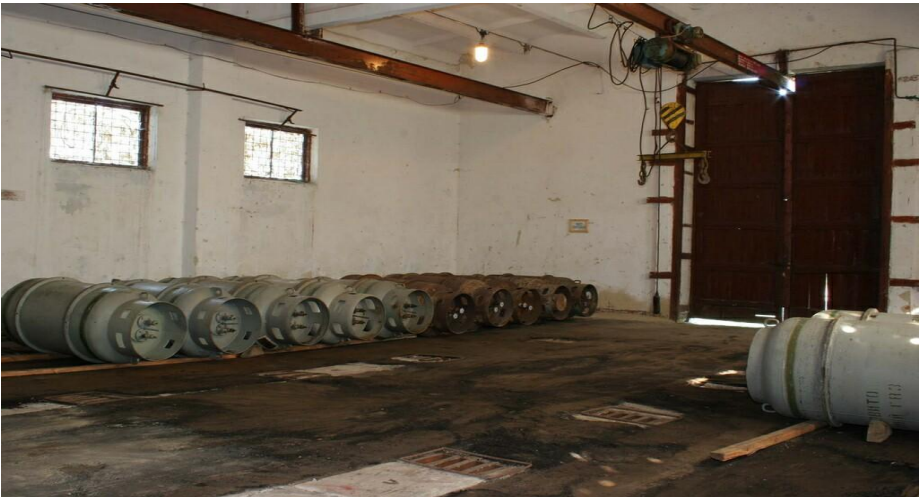
Хлораторна станція «Тернопільводоканалу».
